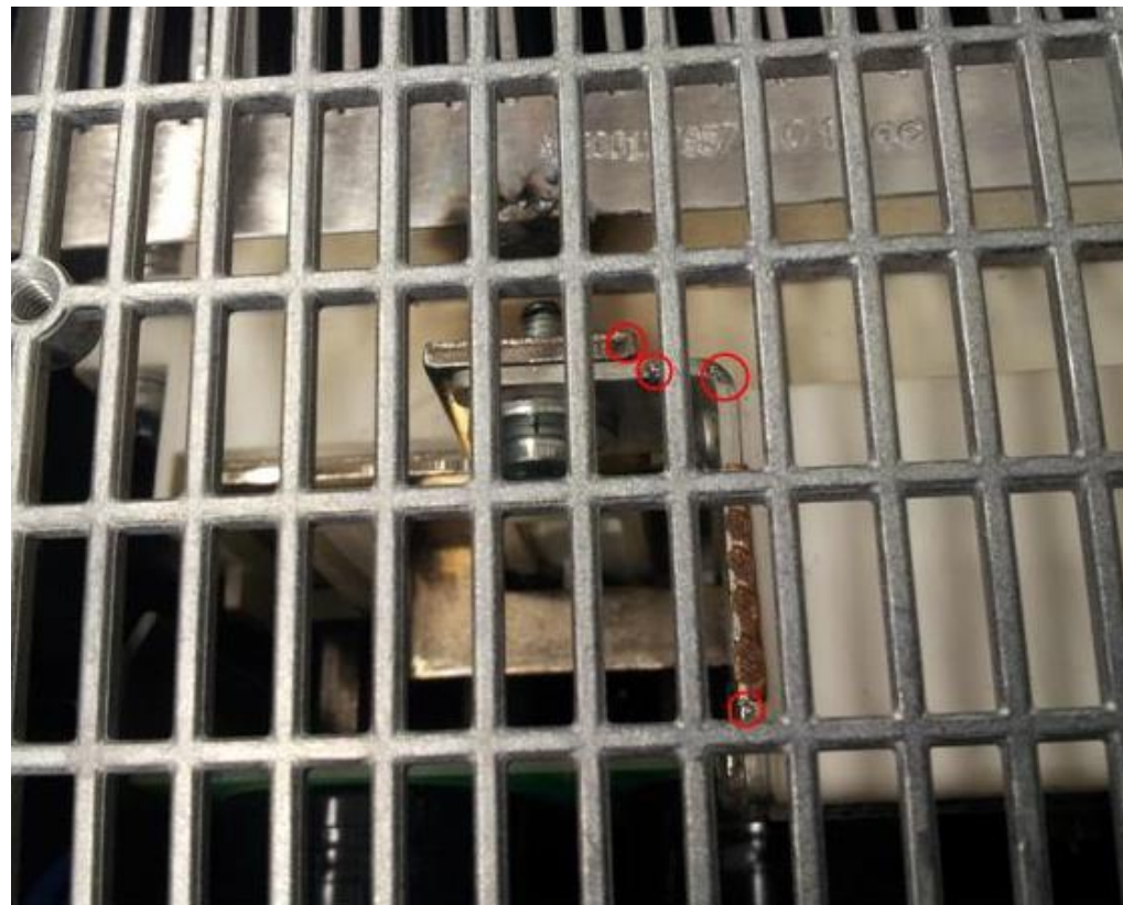
Erdschluss zum Lüftungsgitter
